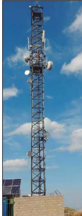
Figura 5.1 Torre 1 del Repetidor de Majalinos.
