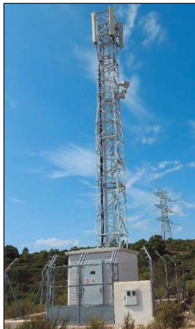
Figura 5.10 Torre propiedad de Movistar del repetidor de Aguaviva.
