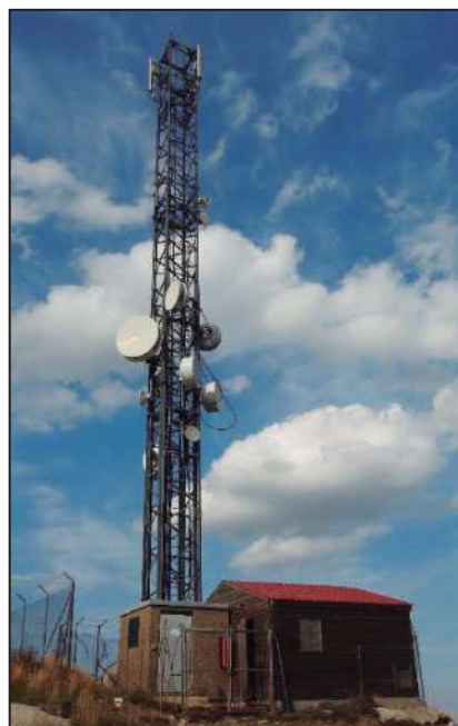
Figura 5.2 Torre 2 del Repetidor de Majalinos.
