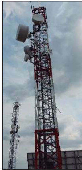
Figura 5.3 Torre 3 del Repetidor de Majalinos.
