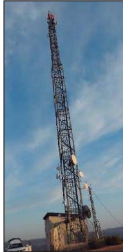
Figura 5.6 Torre de la red pública de Infraestructuras de Telecomunicación de Aragón del repetidor de Bordón.
