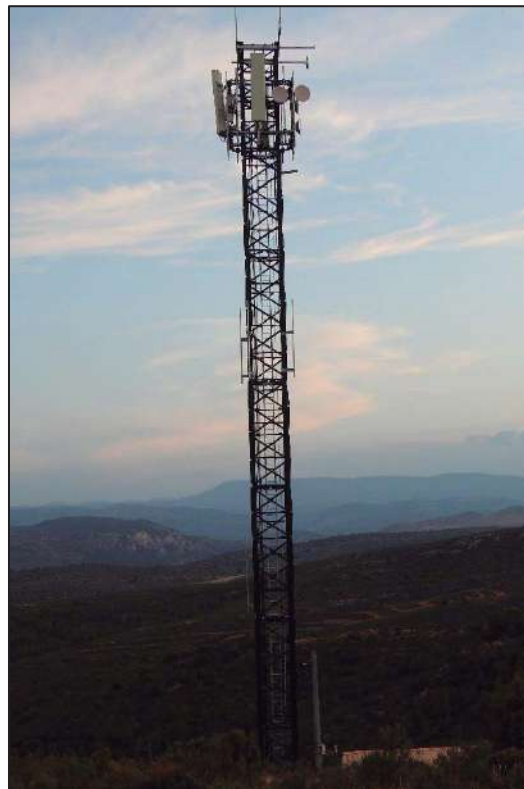
Figura 5.7 Torre de Cellnex del repetidor de Bordón.
