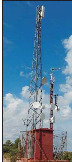
Figura 5.9 Torre de la red pública de Infraestructuras de Telecomunicación de Aragón del repetidor de Aguaviva.
