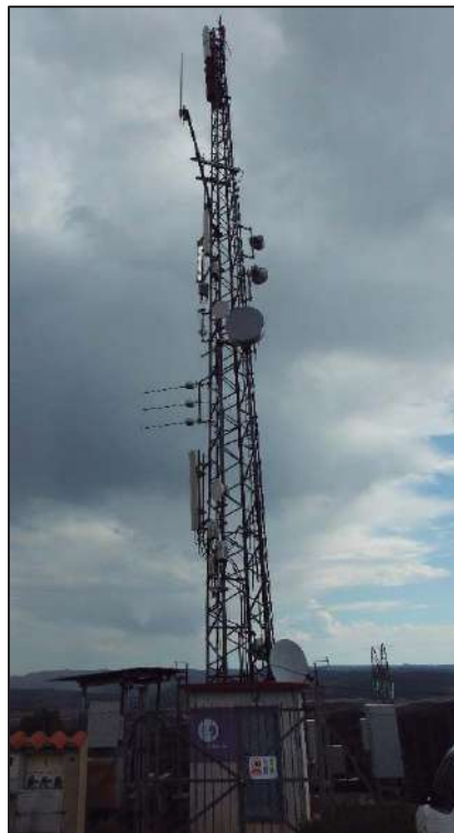
Figura 5.8 Torre de Cellnex del repetidor de Aguaviva.
