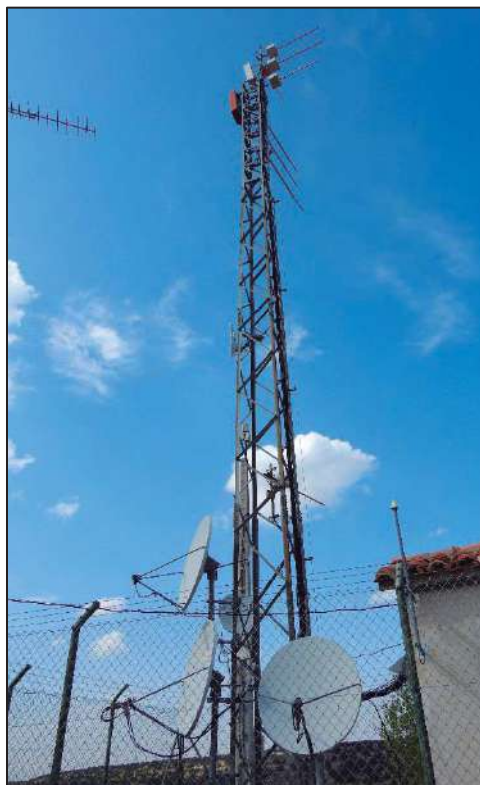
Figura 4.3 Repetidor de Ejulve.
