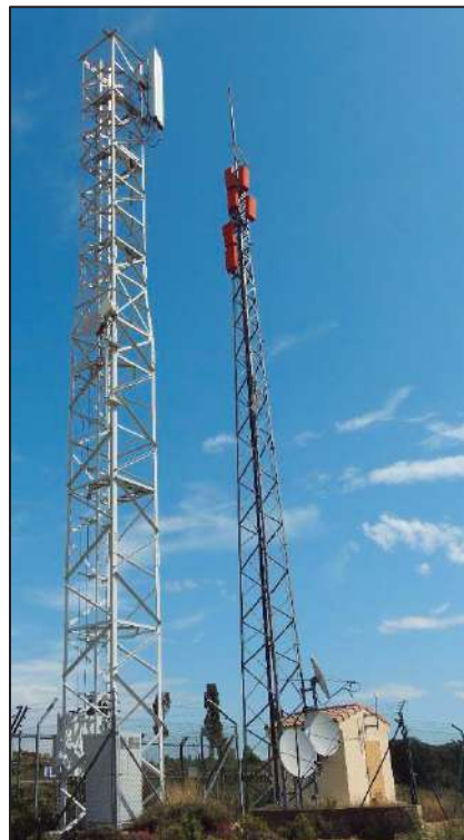
Figura 4.6 Repetidor de Las Parras de Castellote.
